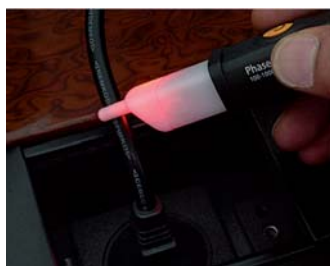
Secuencia de fase incorrecta
